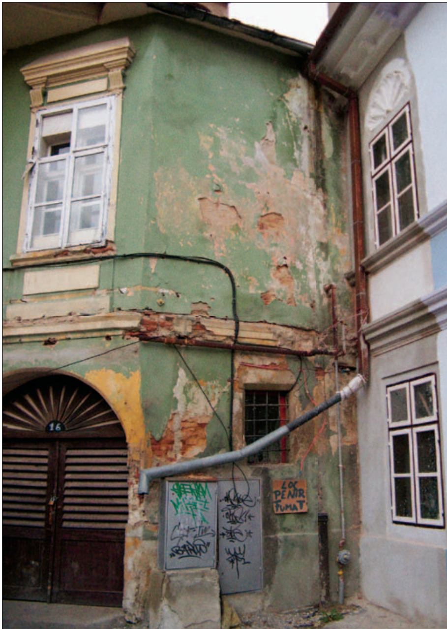
Fassadenverfärbung – zerstörung wegen Feuchte Rumänien Brasov Altstadt
