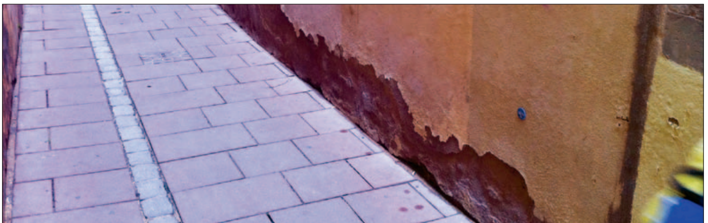
Unsachgemässer Fassadenanschluss Fassadenschäden Rumänien Brasov Altstadt
