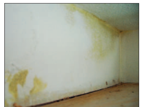
Algenbildung auf Kältebrücke oberhalb Innentüre
