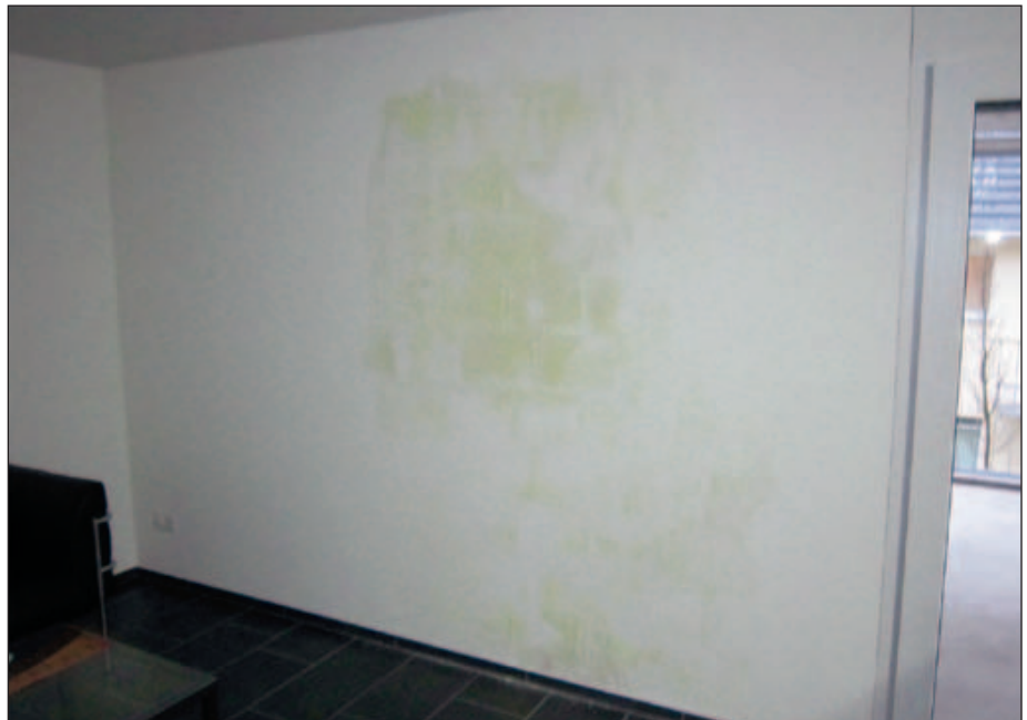
Algenbildung Innenwand wegen mangelhafter Abdichtung
