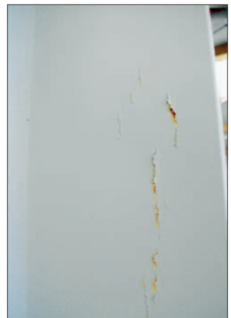
Rostverfärbung einer Beschichtung
