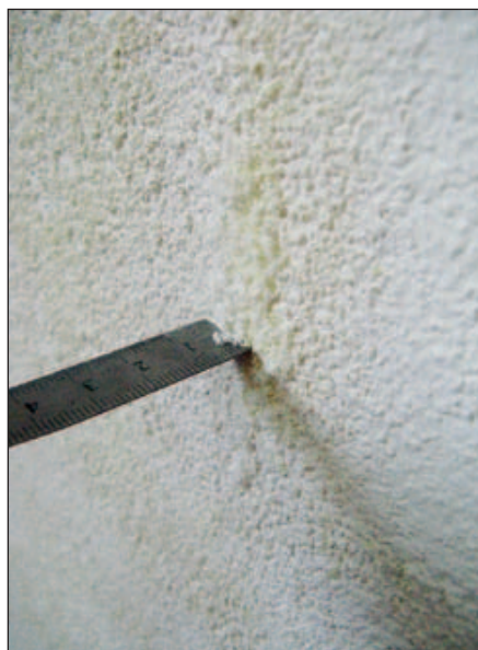
Ausblühungen Innenwand wegen Feuchte
